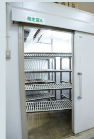
▲養生室 A~C の 3 室完備
